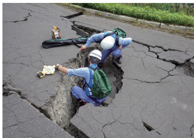
道路施設の被災状況調査
