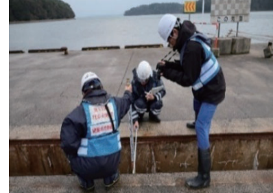
港湾施設の被災状況調査
