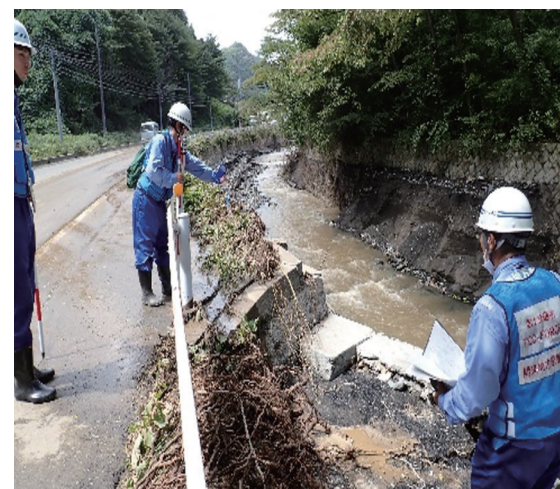
河川施設の被害状況調査
