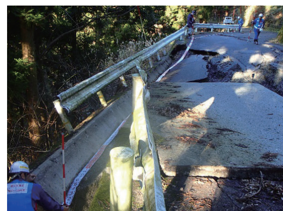
道路施設の被害状況調査
