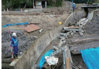
河川施設の被災状況調査
