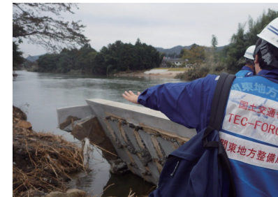
河川施設の被災状況調査
