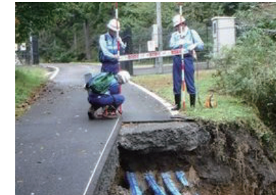
道路施設の被災状況調査
