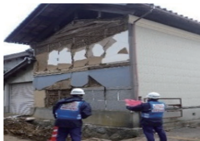
被災建築物応急危険度判定
