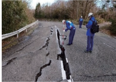
道路施設の被災状況調査
