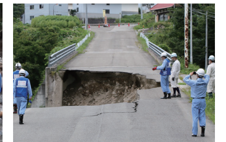
自治体職員と合同での被災状況調査
