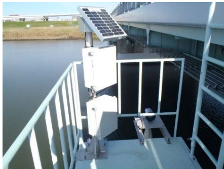
危機管理型水位計の設置(関東地方整備局)
