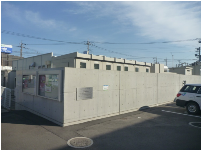
非常用電源の防水壁
