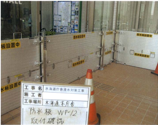
庁舎の浸水板
