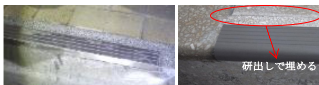
ノンスリップ試験施工 ノンスリップ本施工 写真-4 ノンスリップ写真
