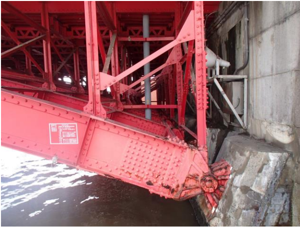
図-2 アーチリブ腐食状況
