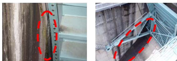
写真-2 4号クレストゲート右岸側漏水状況
