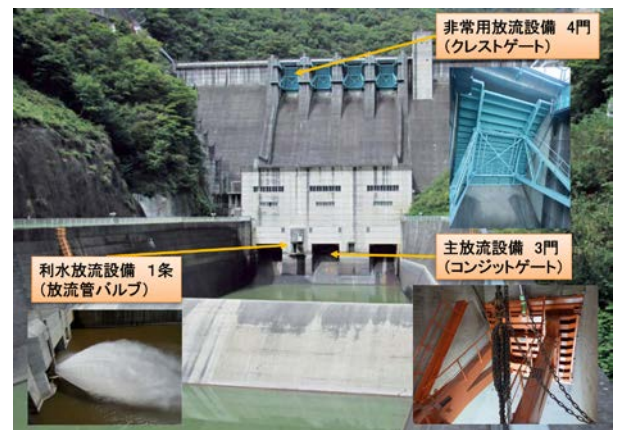
図-1.2 菌原ダム 放流設備
