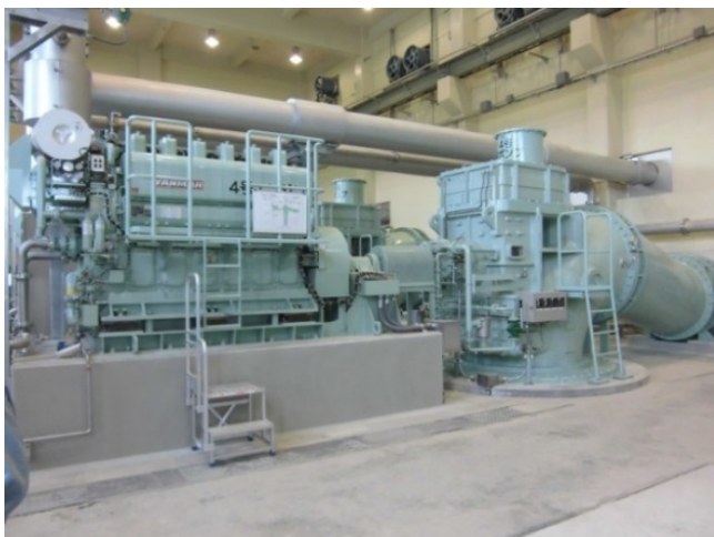
図-1 糠田排水機場ポンプ設備
