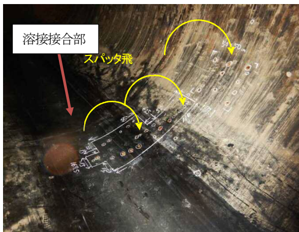
写真－5 溶接接合部におけるスパッタ飛散状況
