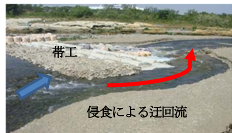
図-7 帯工袖部の侵食状況
