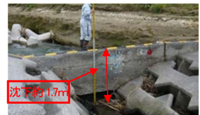
図-2 護床工の沈下状況
