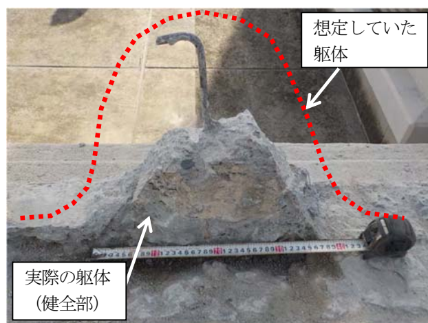
写真-5 はつり出した背面部躯体の健全部
