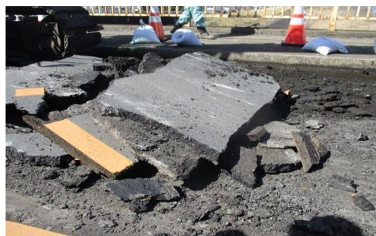
図-5 破碎した舗装版
