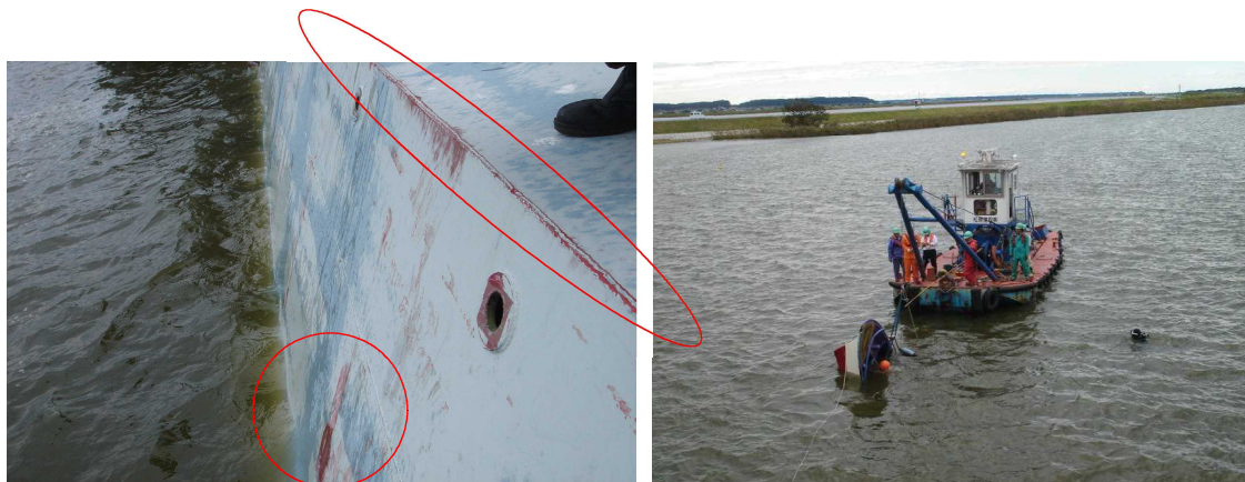
流出放置船が衝突した水門と引き上げの様子（底部の塗装が水門に付着している）
