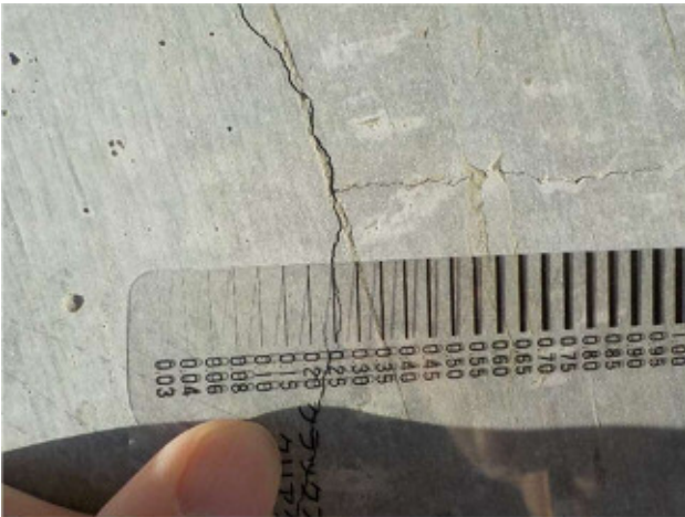
図-6 ひび割れ発生（B社）
