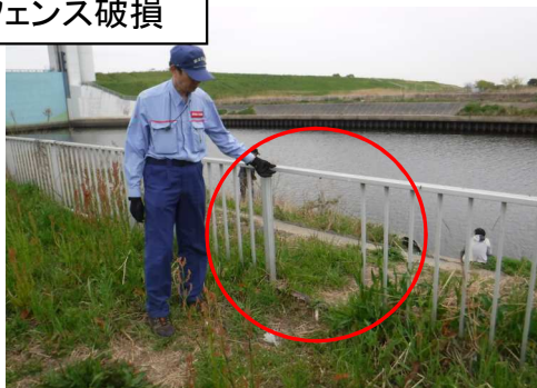
フェンス破損
