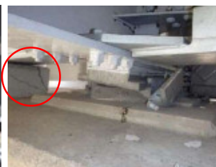
写真-6 支承の破損の状況
