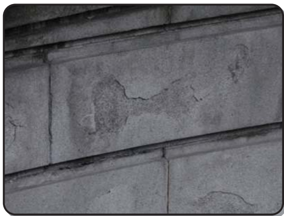
▲石材表面の剥離（はがれ）
