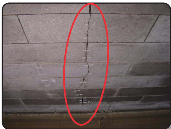
▲石材のひび割れ（裏面）
