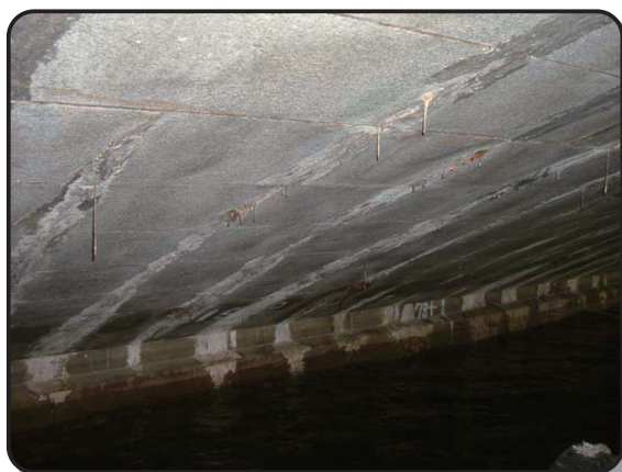
▲石灰分のしみ出し（裏面）
