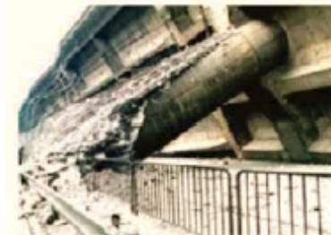
阪神高速道路の橋脚の被災
