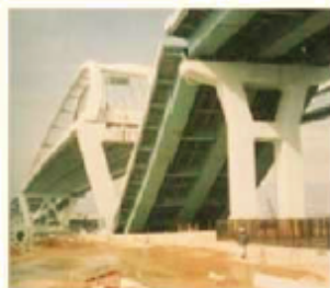
阪神高速道路の落橋
