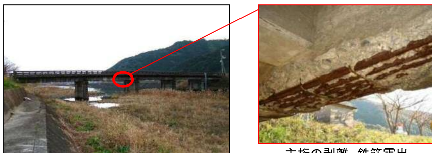
主桁の剥離、鉄筋露出
