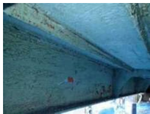
桁の塗装劣化やさびの発生
