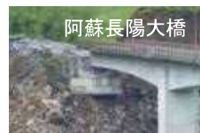
斜面変状による橋台の沈下
