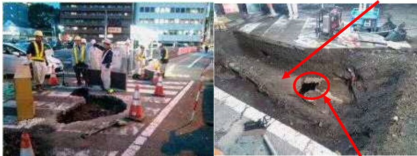
路面陥没 約1.7m×2.6m×0.6m(深さ)
