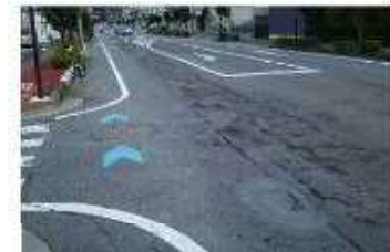
占用工事が起因する路面損傷
