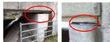
支承交換の作業空間なし
