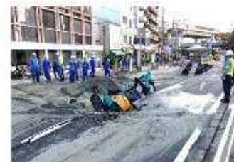
埋設管の老朽化に伴う道路陥没
