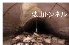
覆工コンクリートの崩落
