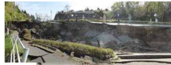
路面陥没地付近の状況（4月15日）
