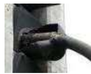
ケーブル損傷例
