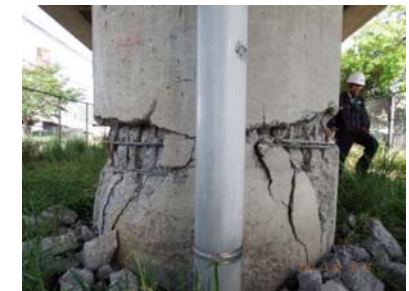
写真-7 段落し部の損傷 市道(1-3)中央線 ちゅうおうせんりつきょう ・中央線陸橋
