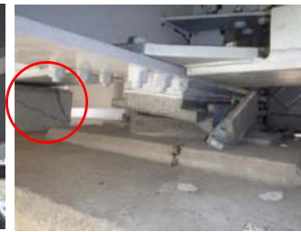
写真-6 支承の破損の状況
