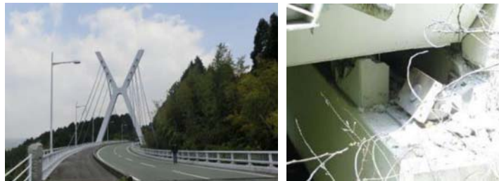
写真-2 支承部の損傷に伴う桁端部の浮き上がり (県道熊本高森線・桑鶴大橋)
