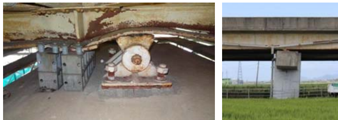
写真-1 支承部の損傷及び橋脚の傾斜 (九州自動車道・木山川橋)
