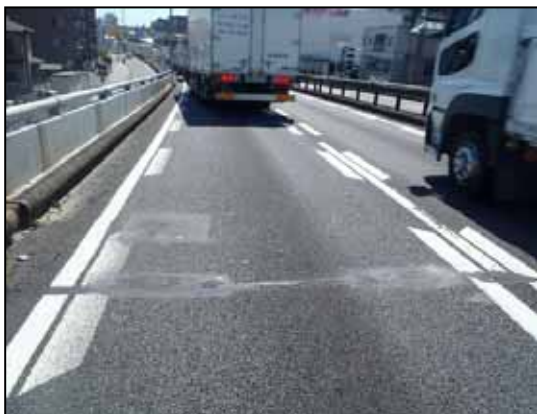
*写真は国道16号橋本陸橋でのジョイント損傷状況
