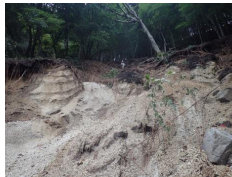
上流崩壊状況
