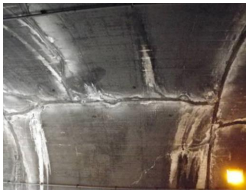
頂部のひび割れ
