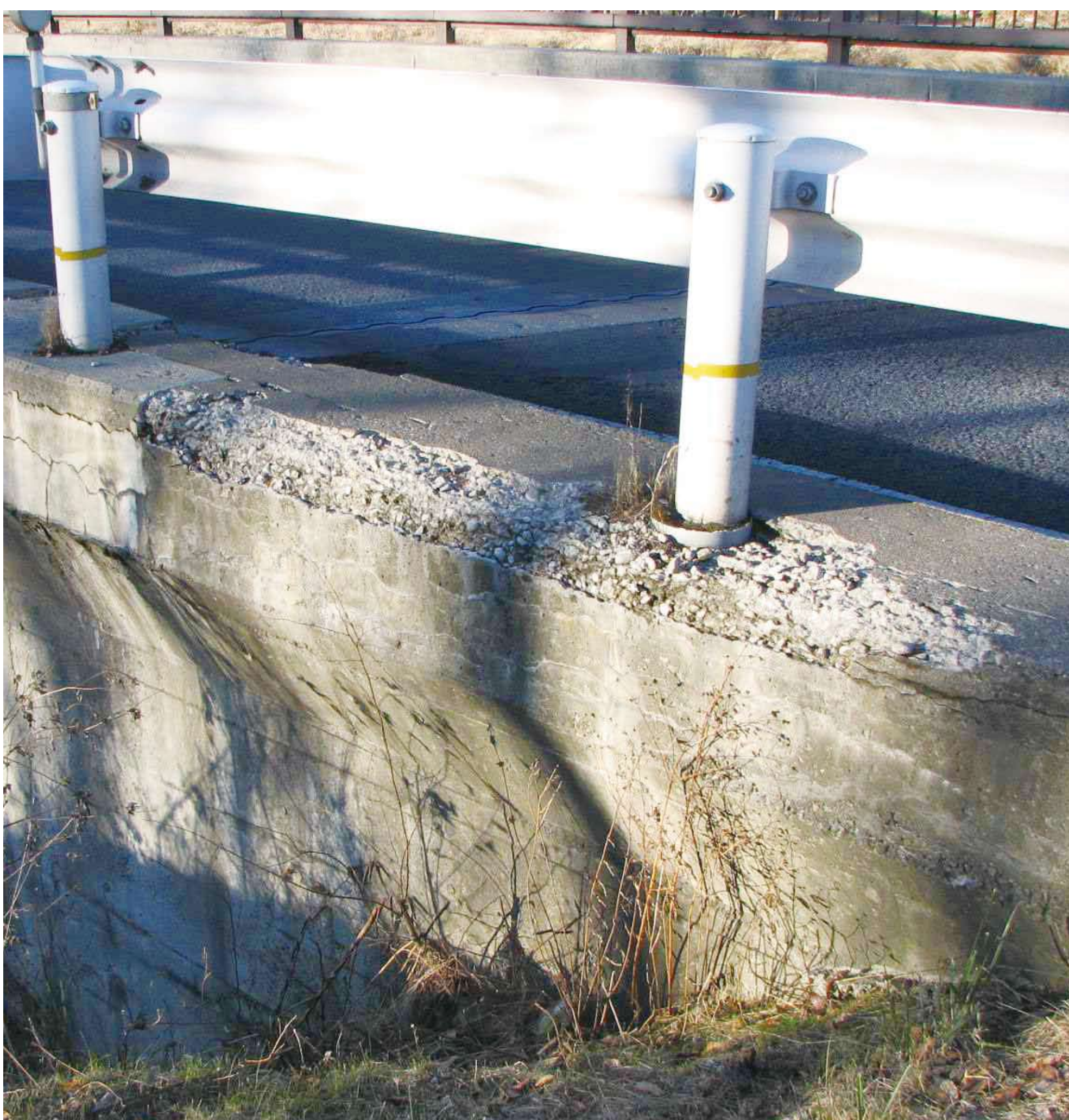
凍害によるコンクリートの剥離
