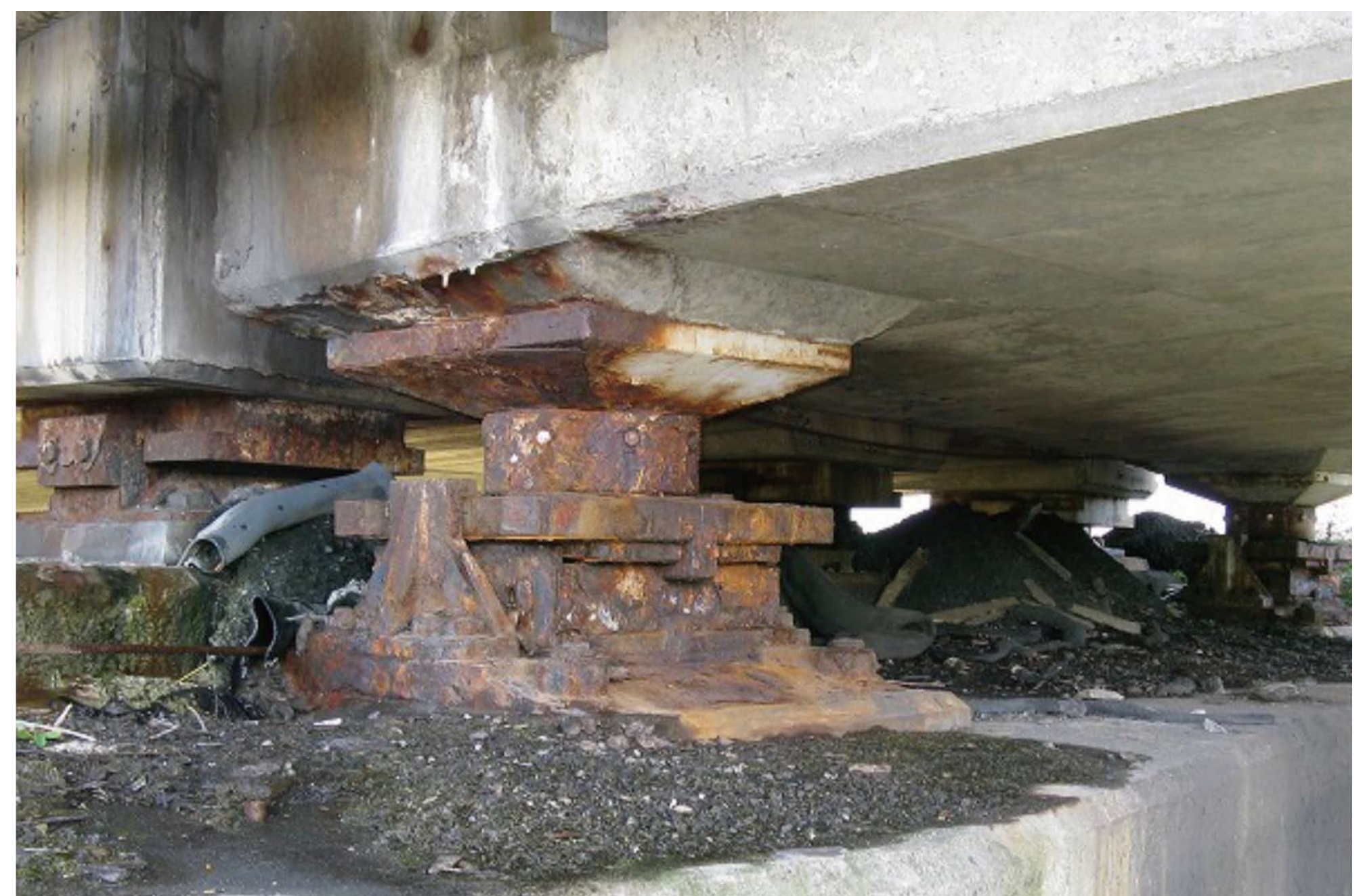
漏水による腐食(支承)
