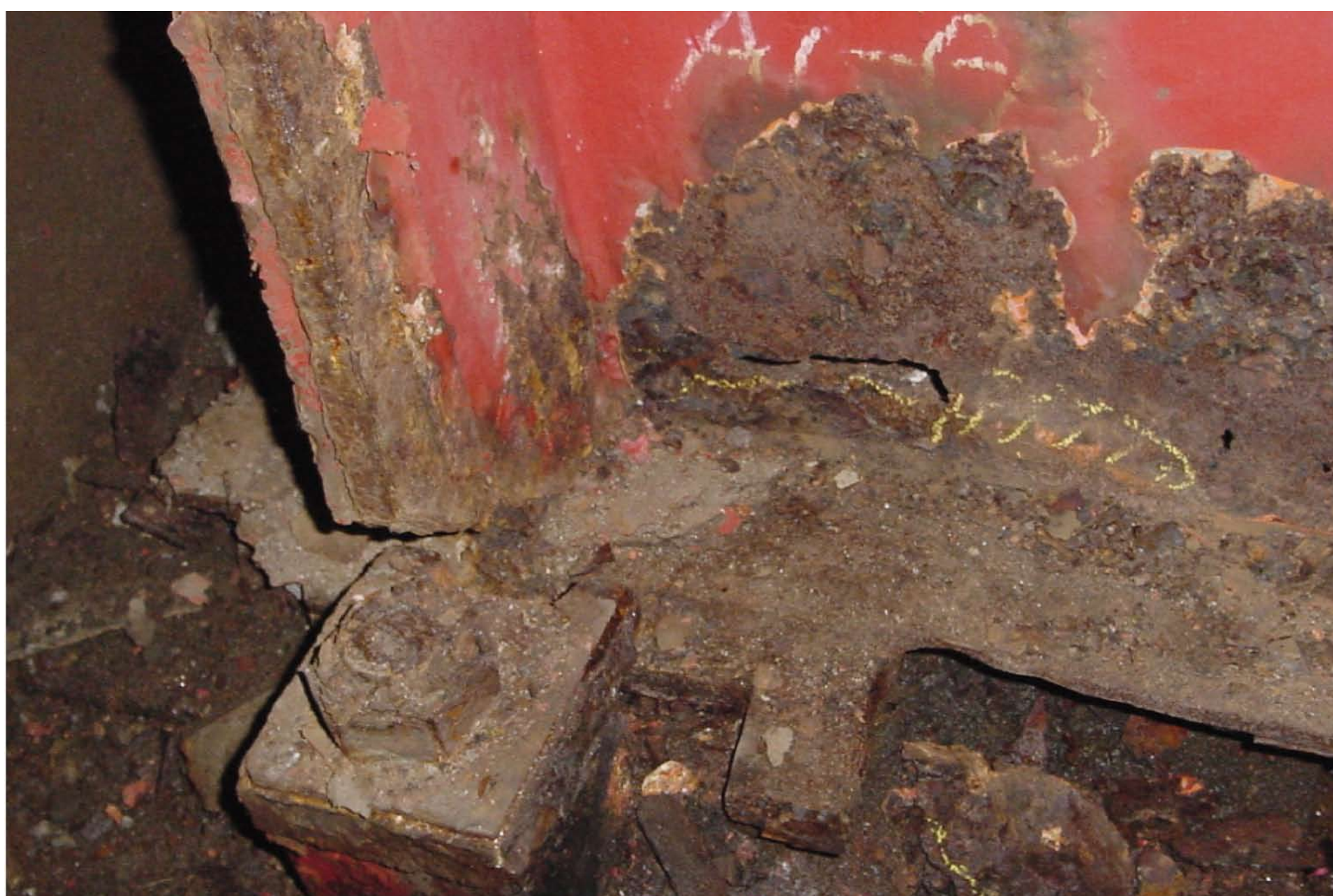
漏水による腐食(桁端部)
