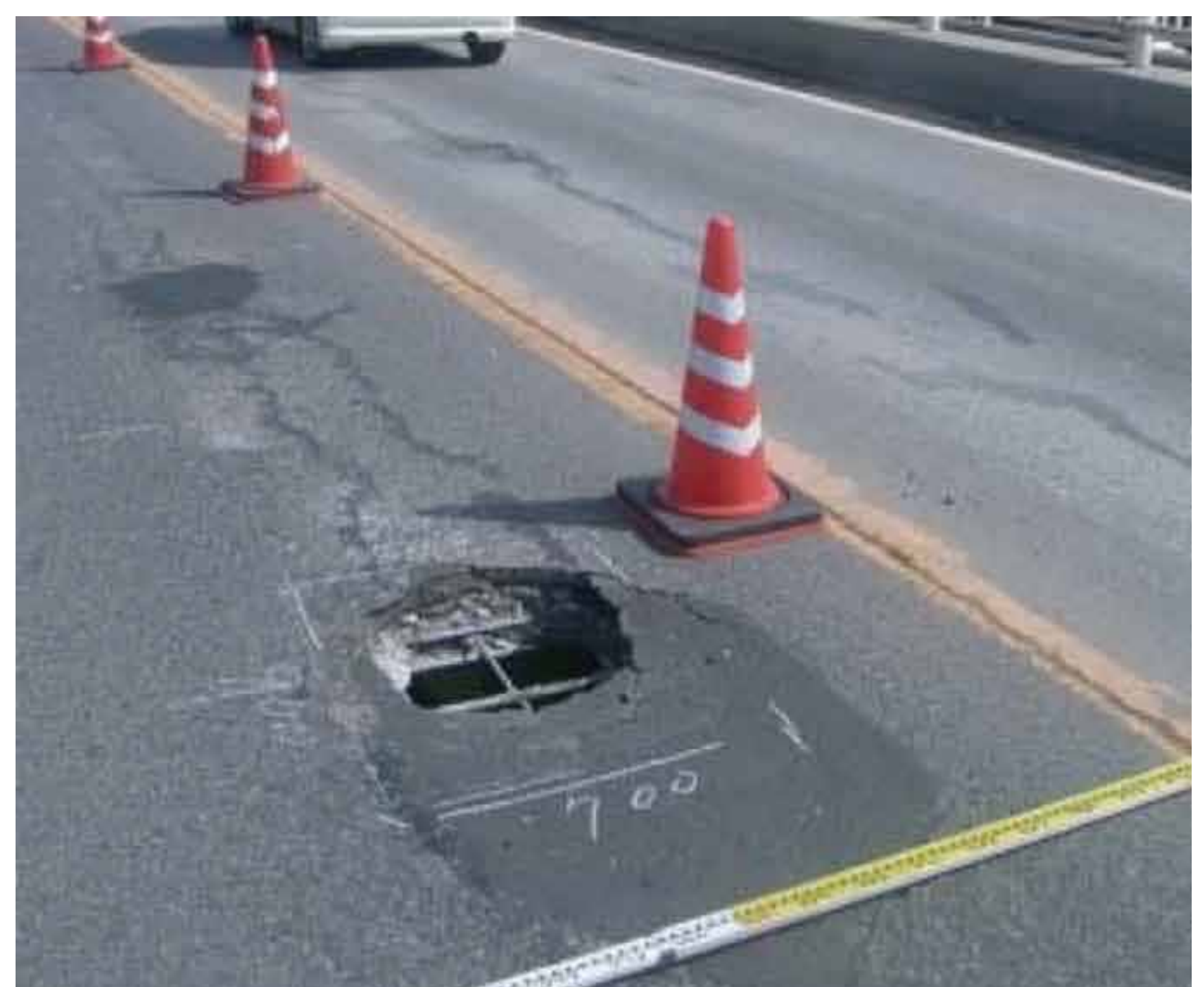
コンクリートの床版が抜け落ち、舗装に空いた穴
