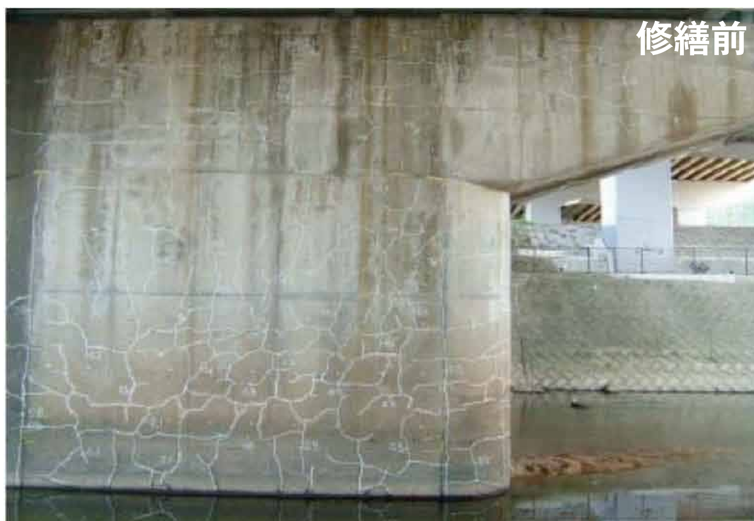
アルカリ骨材反応によりひび割れが発生
