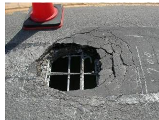
【道路が損傷した例】
