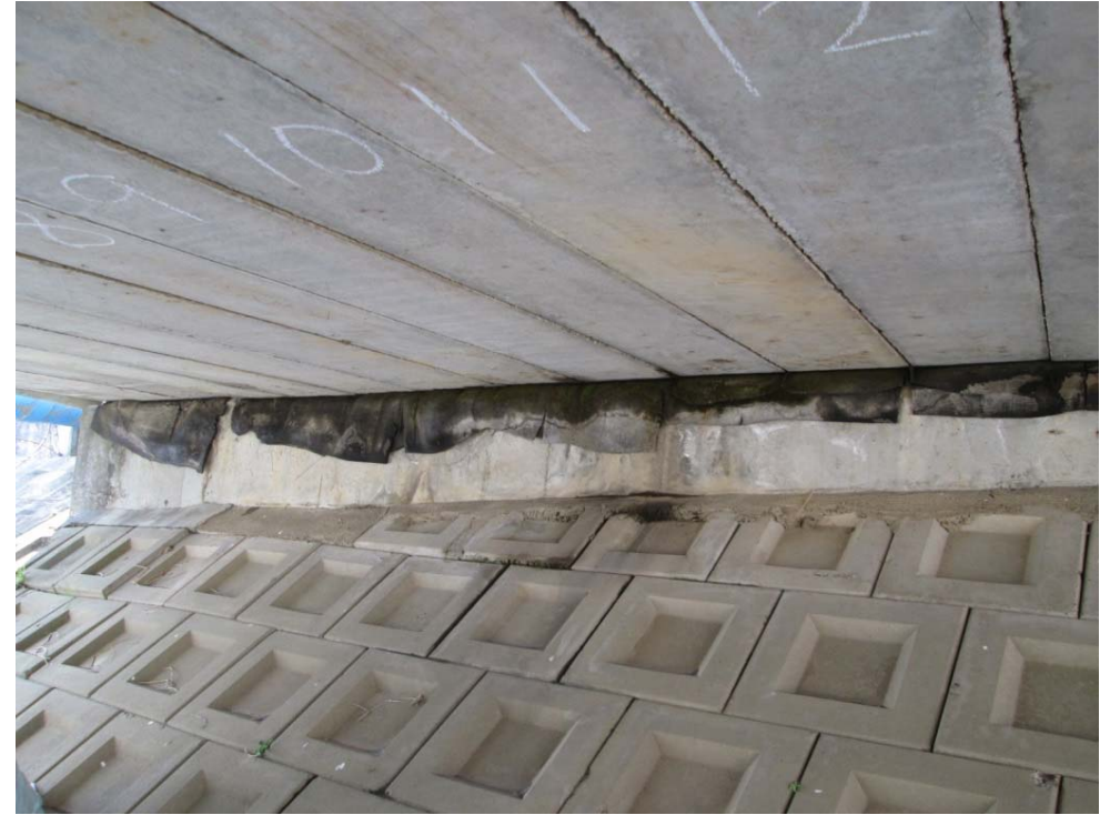
ゴム支承劣化事例
