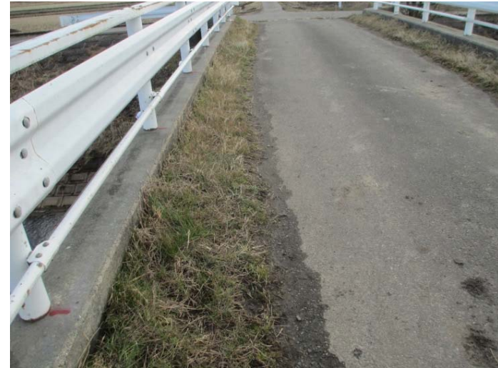
舗装上への土砂堆積
