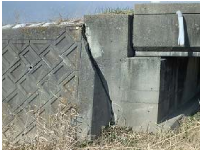
橋台取付部と擁壁のずれ
