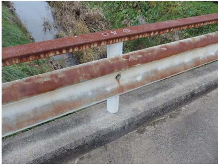
防護柵の劣化
