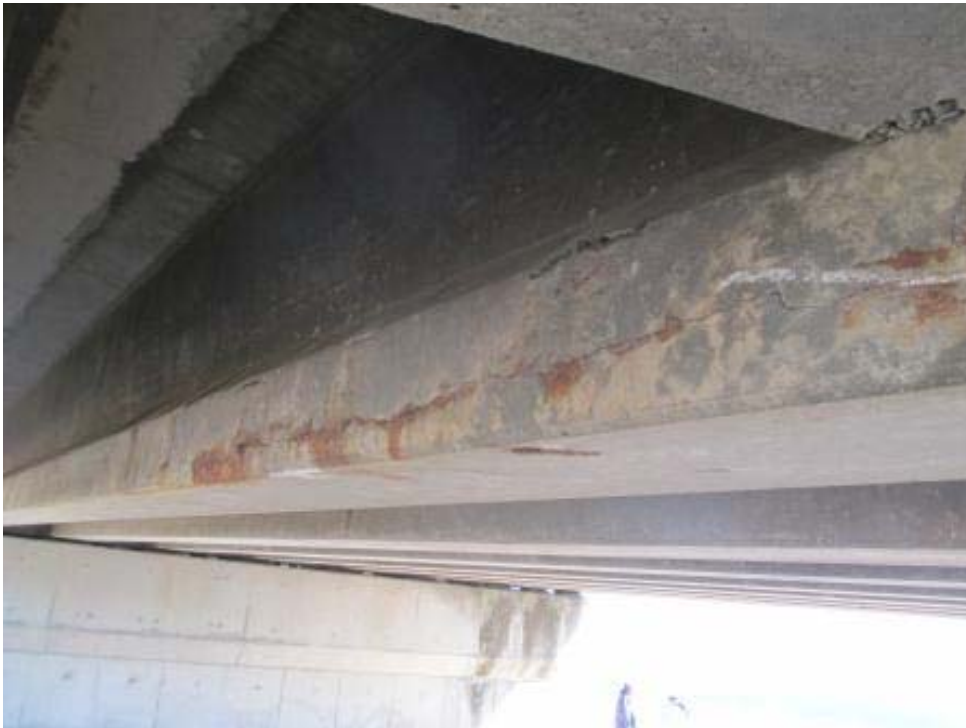
塩害によるものと思われるひび割れ
