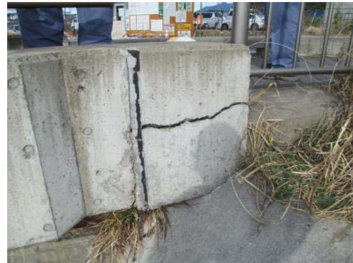
地覆端部のひび割れ
