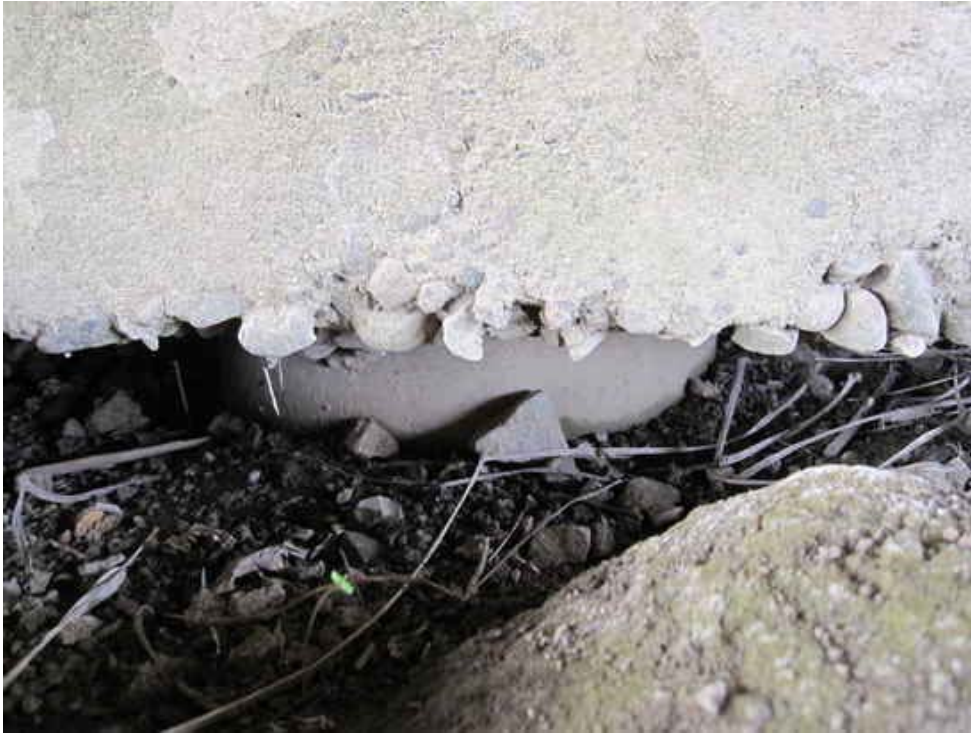
基礎洗堀事例
