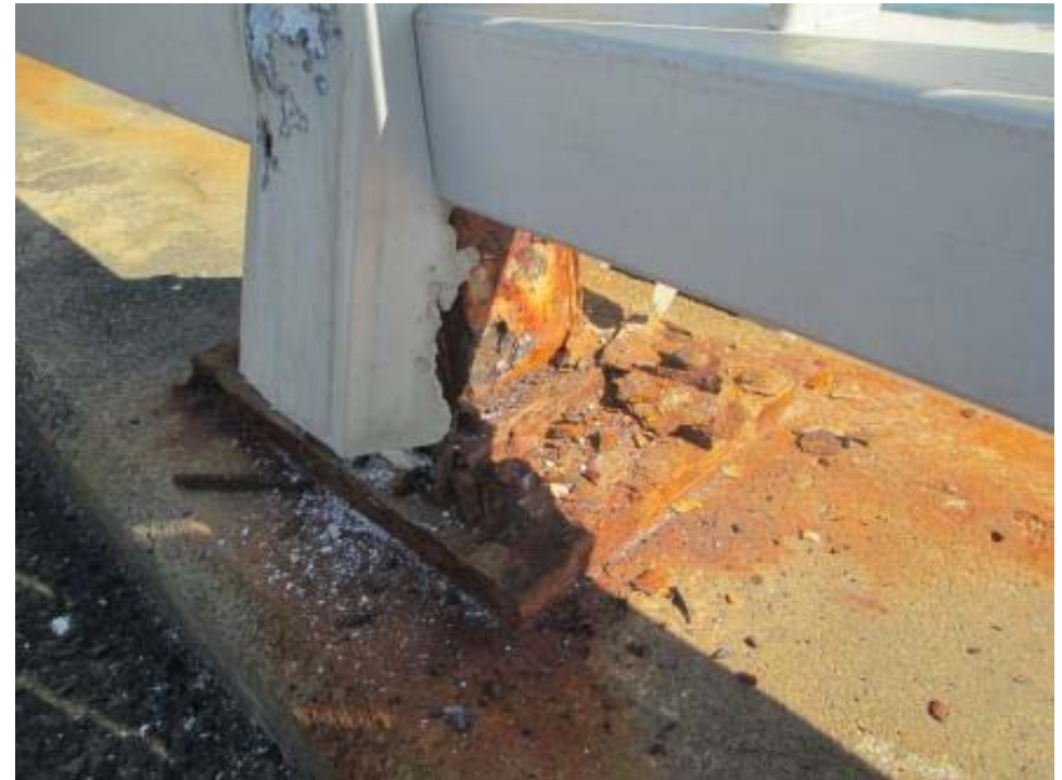
塩害及び異種金属疲労接触腐食によるものと思われる
