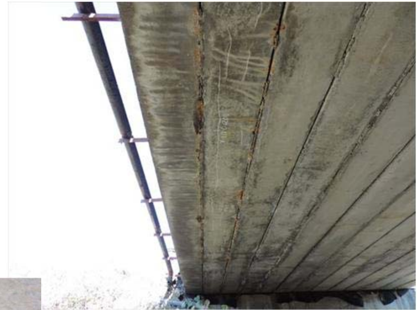
部分的なひび割れ
