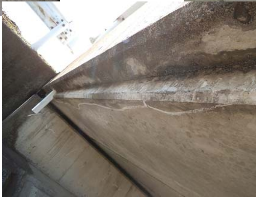
主桁(床板)漏水状況
