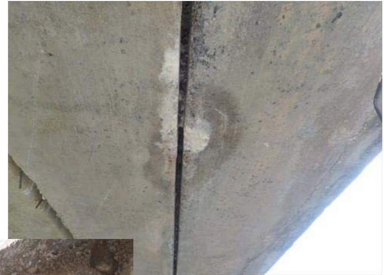
車道からの漏水
