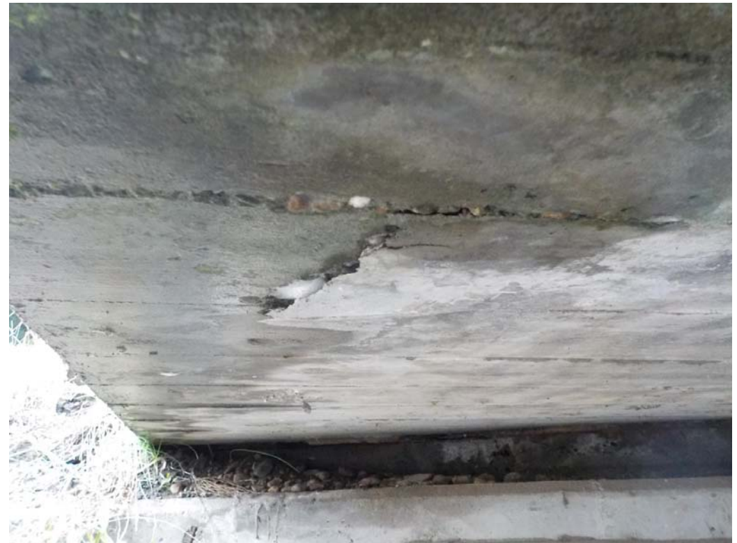
損傷状況(地覆等からの漏水)
