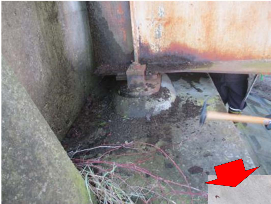
鋼橋腐食・防食機能劣化
