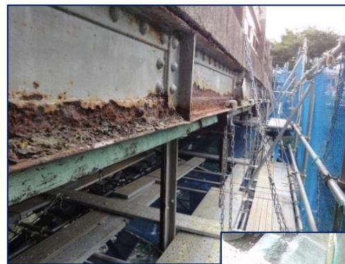
主桁の腐食状況
