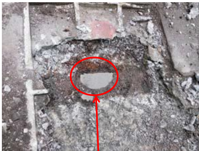
デッキプレートの孔食を伴う著しい腐食
