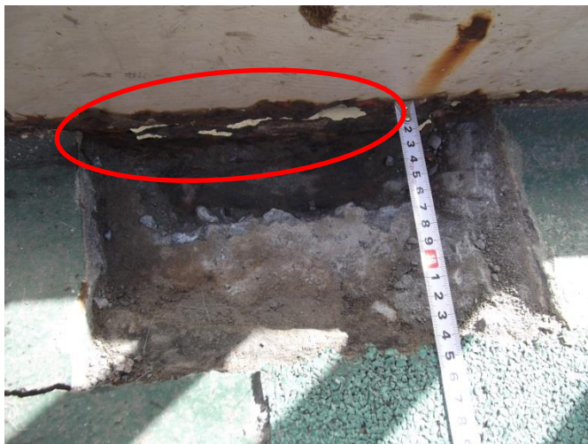
橋面舗装の試掘で明らかになった地覆部腐食
