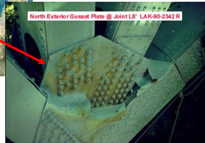
過去のガセットプレートの座屈事例
