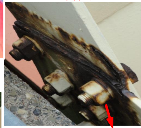
断面急変部の 腐食による減肉
