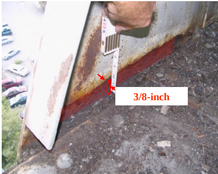
ガセットプレートの局所腐食欠損の例
