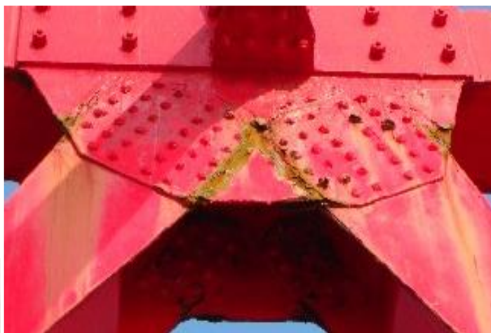
ガセットの腐食
