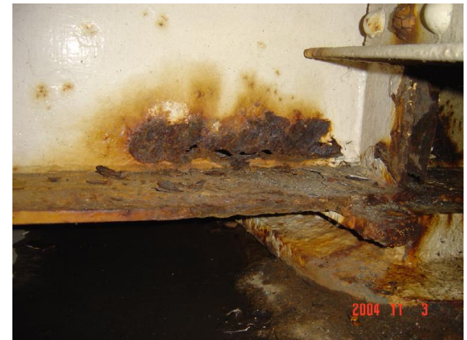
局部的な腐食
