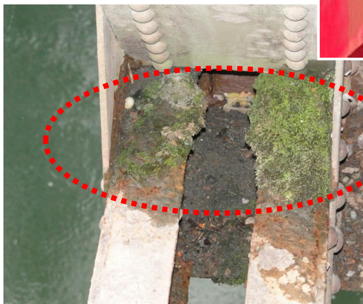
土砂堆積と腐食
