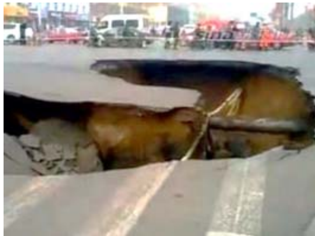
水道管の老朽化による道路陥没 (年間5000件以上)
