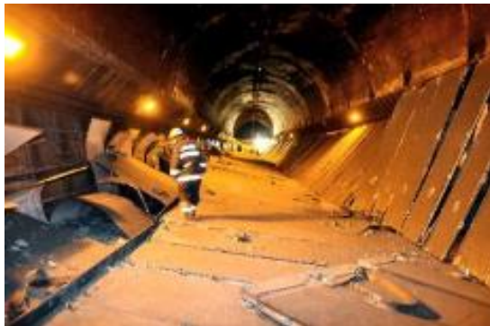
笹子トンネル崩落事故 (2012年12月)
