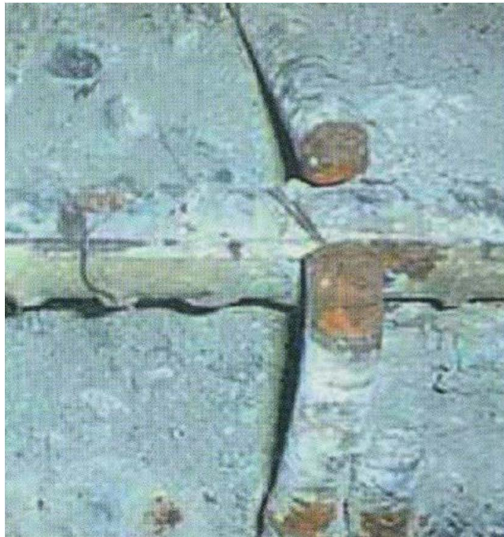
コンクリート内部の 鉄筋破断の例
