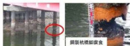
【重大な損傷の事例(橋梁)】
