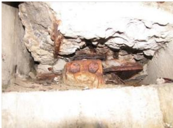
支承部の損傷
