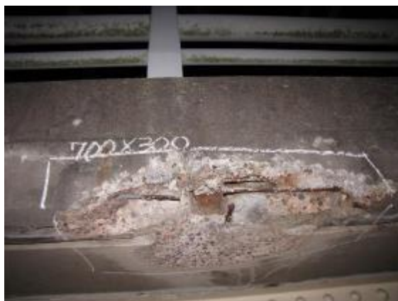
張出床版の鉄筋露出
