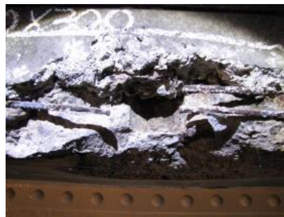
同左 鉄筋の破断
