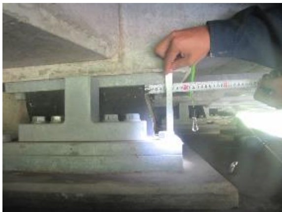
ゴム支承の変形
