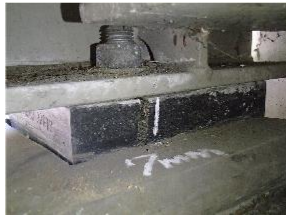
ゴム支承の損傷
