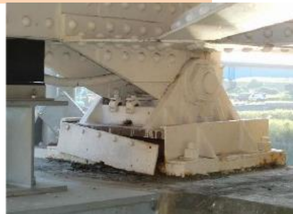
支承部カバープレートの脱落
