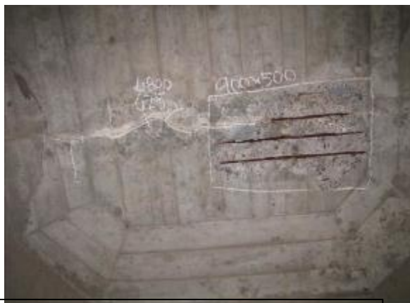
床版の鉄筋露出・遊離石灰
