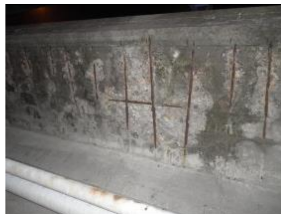
張出床版の鉄筋露出
