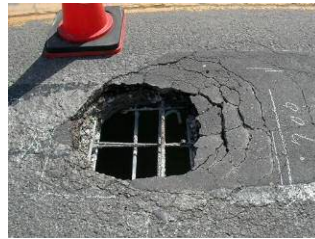
【道路が損傷した例】
