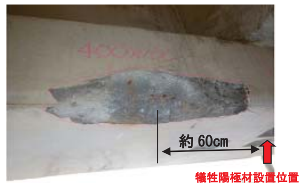
写真-1 損傷状況(SP-41劣化部No.1近傍)
