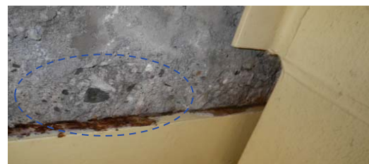
写真-3 ハンチ部の剥落状況 (青色部分)
