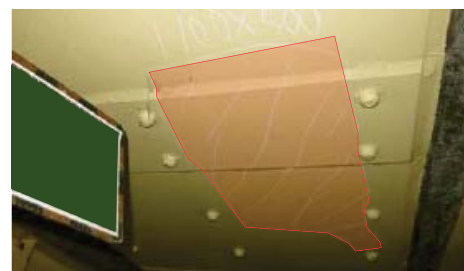
写真-2 補強鋼板のうき状況 (赤色部分)
