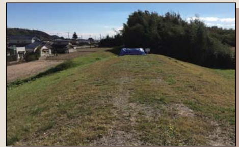
▲断面が不足している堤防
