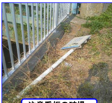
注意看板の破損
