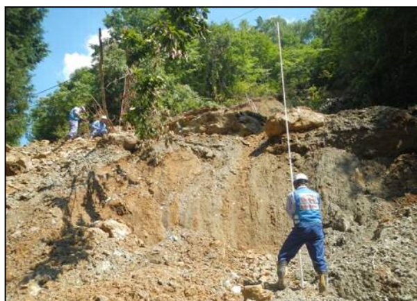
7/16 被災状況確認 (岡山県新見市)
