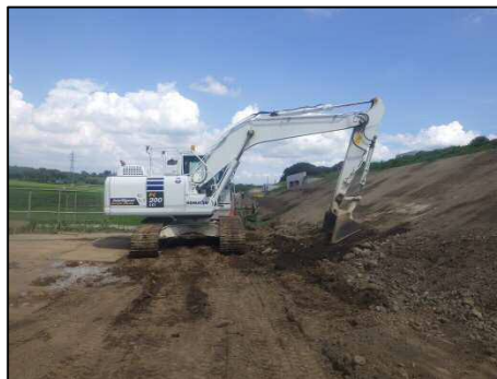
MC(マシンコントロール)による法面整形 (新技術：インテリジェントMCパッドの使用)
