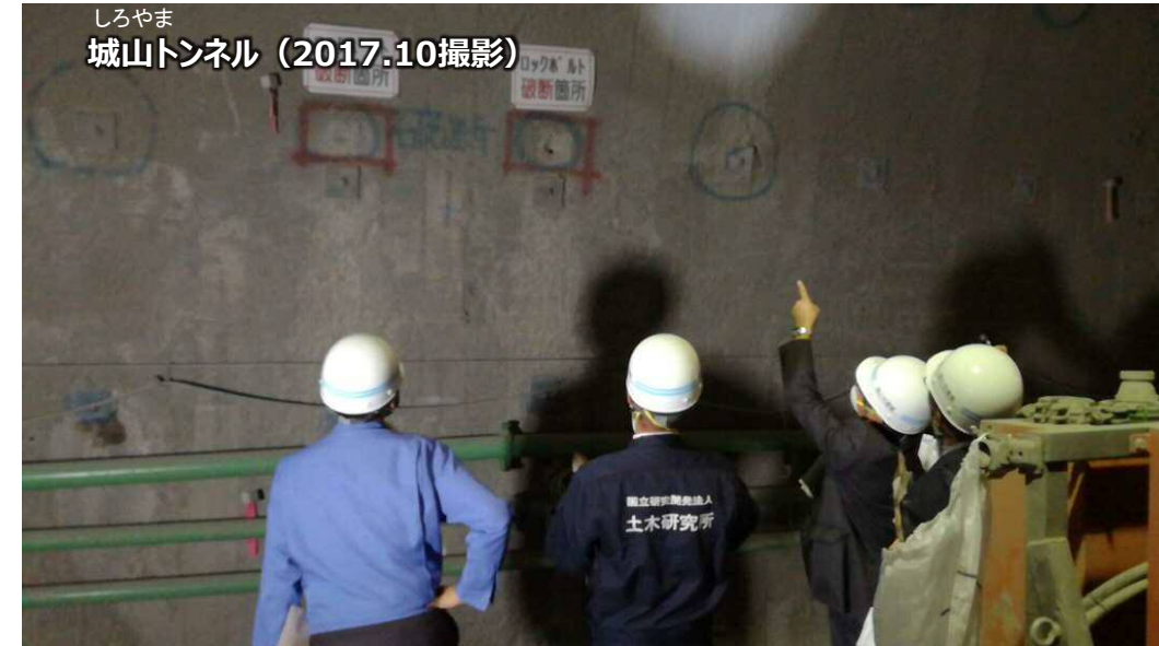
ロックボルト破断箇所(2017.7発生)の確認
