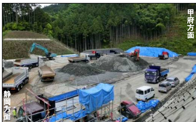
■掘削土の重金属含有を判定するヤード(森山トンネル) もりやま
