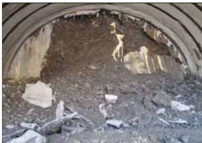
■掘削面の崩落(楮根第3トンネル) かぞね
