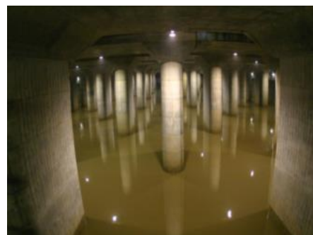
稼働中の調圧水槽（地下神殿）
