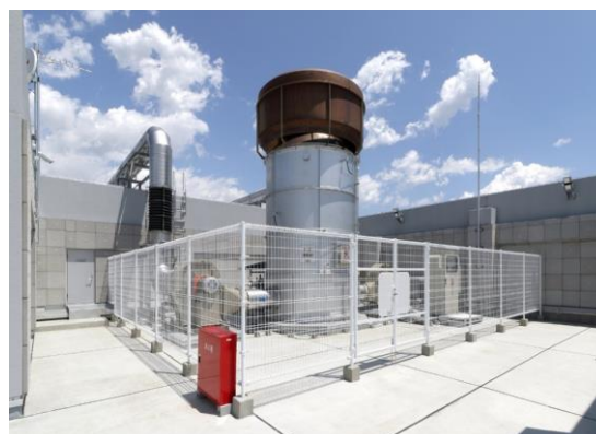
図-9 排煙処理設備
