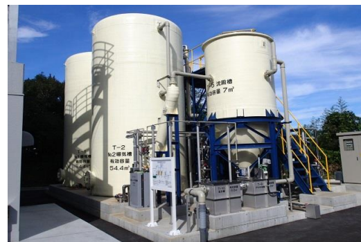
図-12 たん白泡消火剤排水処理設備
