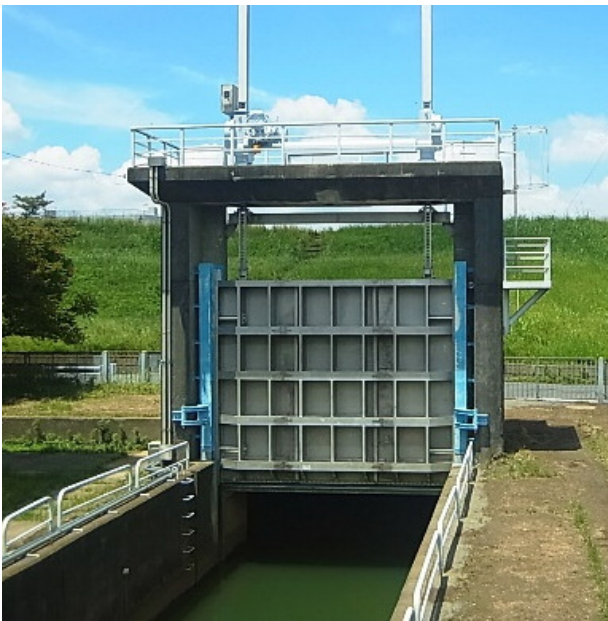
写真-4 完成したゲート設備
