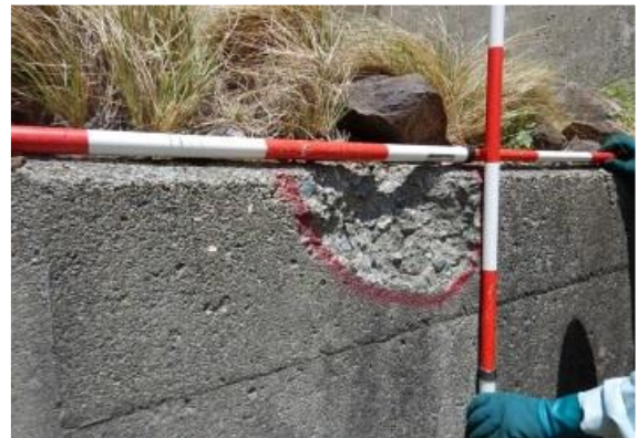
図-7 破損状況 (従来の点検)
