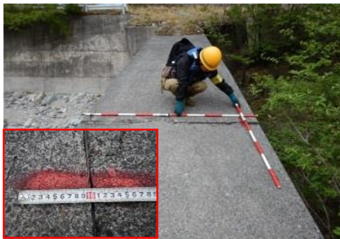
図-5 ひび割れ状況 (従来の点検)
