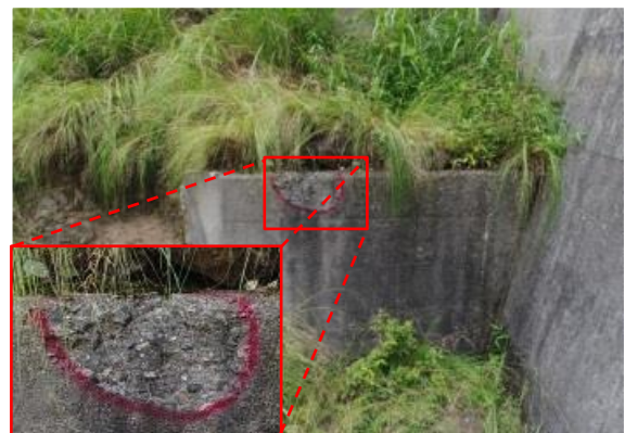
図-8 破損状況 (UAV) (水平写真の拡大)
