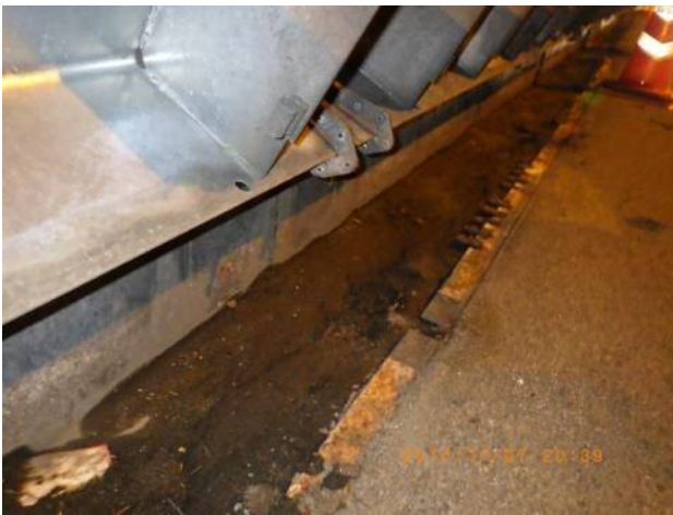
写-7 現地状況 (排水清掃前)
