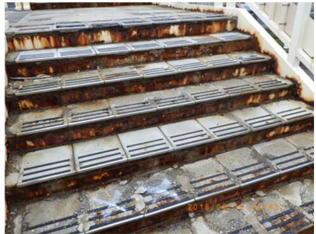
写-1 横断歩道橋 ノンスリップタイル損傷状況
