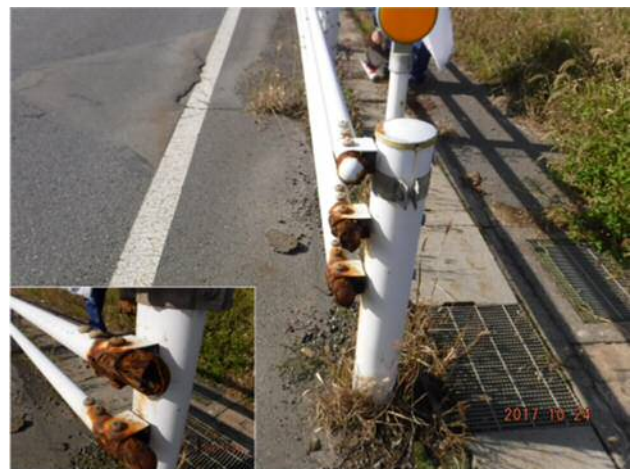
写-2 ガードパイプ腐食状況
