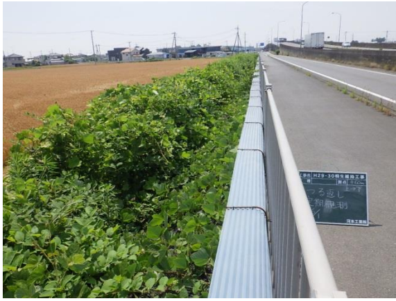
写真－1 1 6月上旬における法面部の状況
