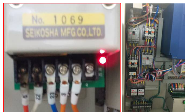
写真 1 : 焼損したサイレン制御盤 端子部
