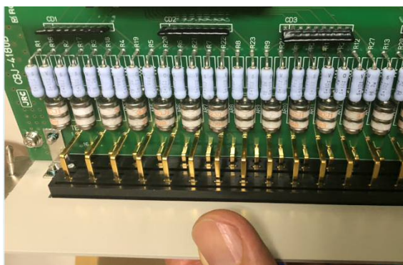
写真2 損傷した機器内部の避雷素子
